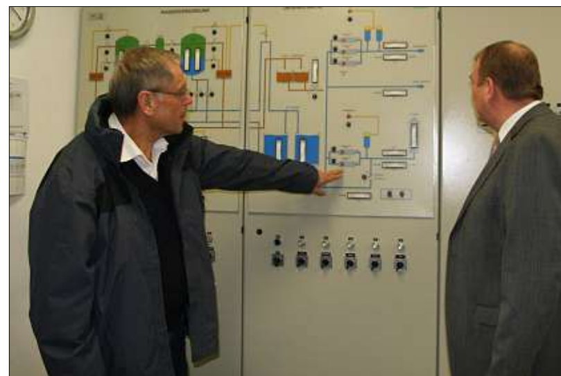
Die Sanierung der Anlagen soll in den nächsten Jahren erfolgen. Ein Bild davon machen sich Werksleiter Wolfgang Plingsanser und Vorsitzender Josef Stöcker (l.) hier in der Zentrale in Neukirchen. – Foto: Sagmeister
